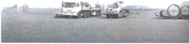
Bốc dỡ và vận chuyển vật tư xây dựng Nhà máy lọc dầu Dung Quất
