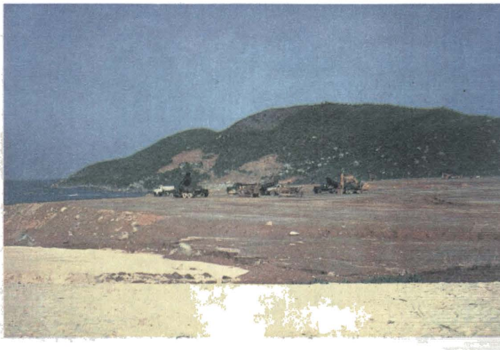
Ngày đầu thi công mặt bằng gói thầu EPC 3 (Khu bể chứa sản phẩm)
