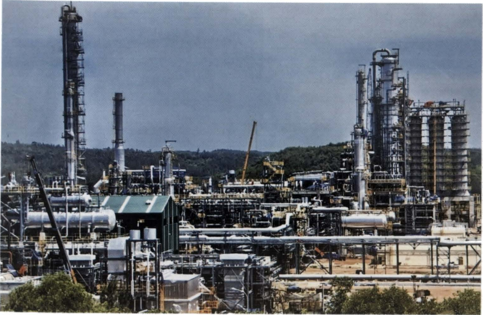
Nhà máy lọc dầu Dung Quất
